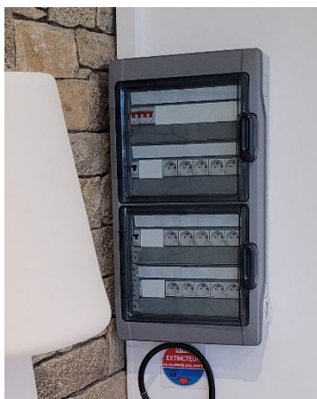
Coffret électrique avec 3 séries de 5 prises 16A avec disjoncteur
